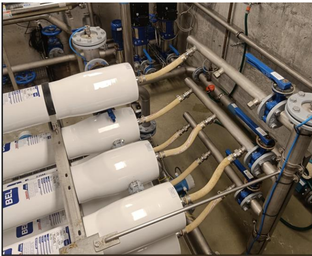
Figur 2-2. UV-anlegg i vannbehandlingsanlegg.
