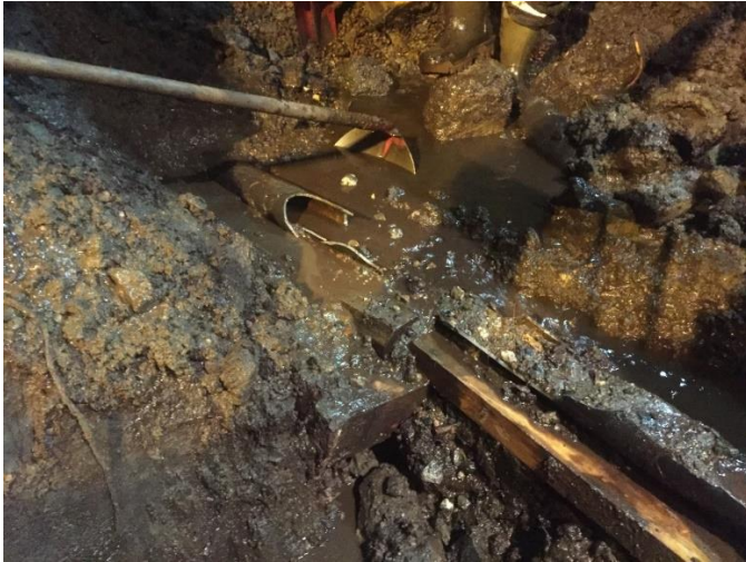
Figur 1-5. Brudd på avløpsledning.
