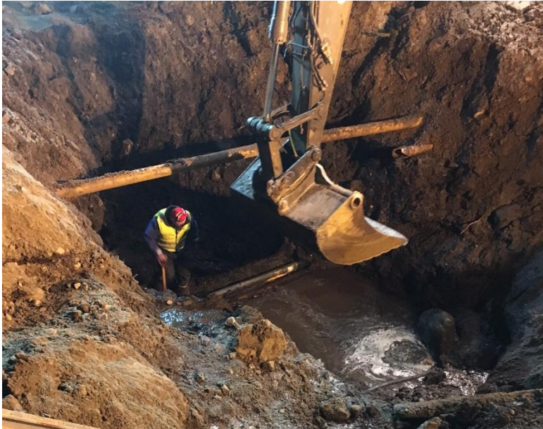
Figur 1-2. Eksempel på vannlekkasje i Iveland kommune.
